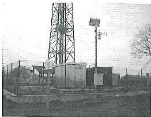
Figura 8 - Stazione pluviometrica di Marene.
