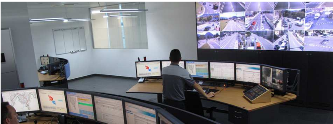
Figura 17 - Soluzione Multimonitor x Sala Operativa
